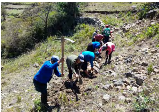
Mujeres junto a sus esposos realizando el trabajo de construcción de terrazas de formación lenta – Com. Yanapaccha
