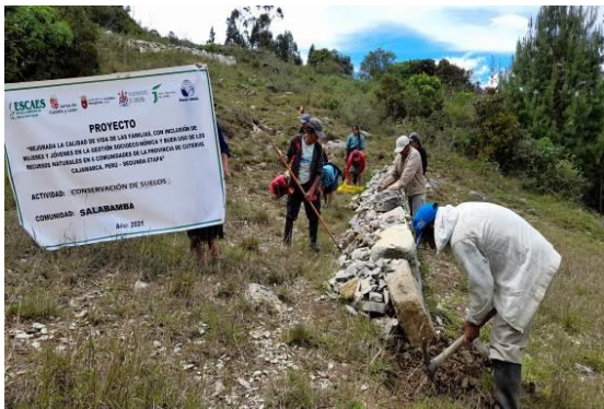
Mujeres junto a sus esposos realizando el trabajo de construcción de terrazas de formación lenta – CP Salabamba
