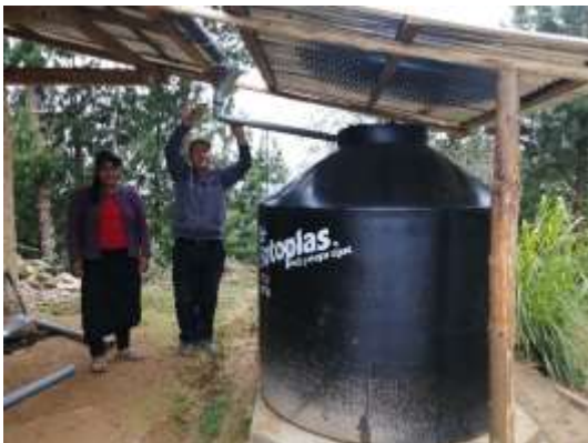
Captando agua de lluvia en tanques de 2500 litros
